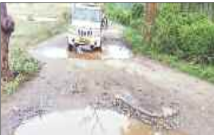
कोटगहना कुसमी मार्ग की जर्जर सड़क।
